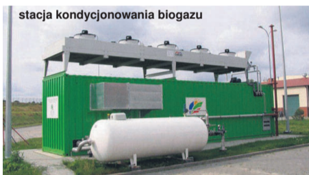
stacja kondycjonowania biogazu
